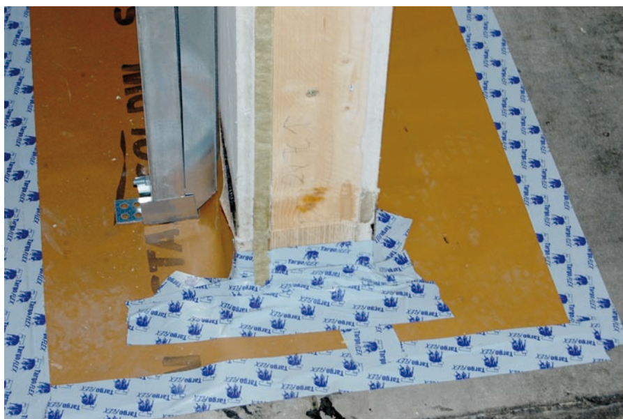
Alle Anschlüsse und Durchdringungen in den Decken wurden rauchdicht ausgebildet. Im Falle eines Feuers kann der Rauch, vom dem bei einem Brand eine viel höhere Gefahr ausgeht als vom Feuer, nicht in die anderen Geschosse gelangen.
