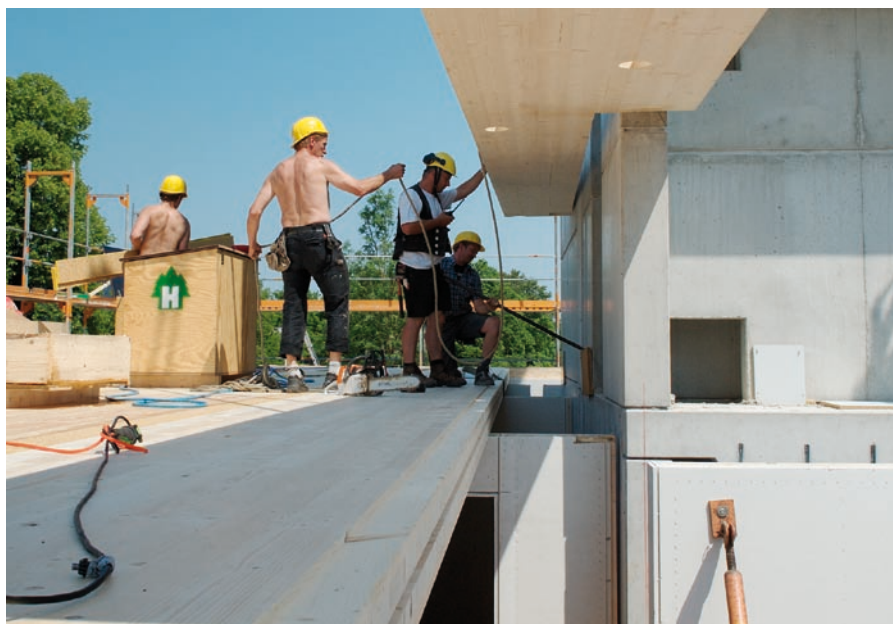
Die Deckenelemente sind aus Brettspertholz. Die Auflagerbereiche wurden mit Bohrungen versehen, die mit Beton vergossen wurden. Somit ruhen die tragenden Wände auf setzungsunempfindlichen Betonpolstern.
